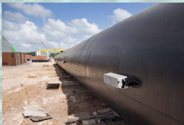
Протекторы АЦК, установленные на трубопроводе
